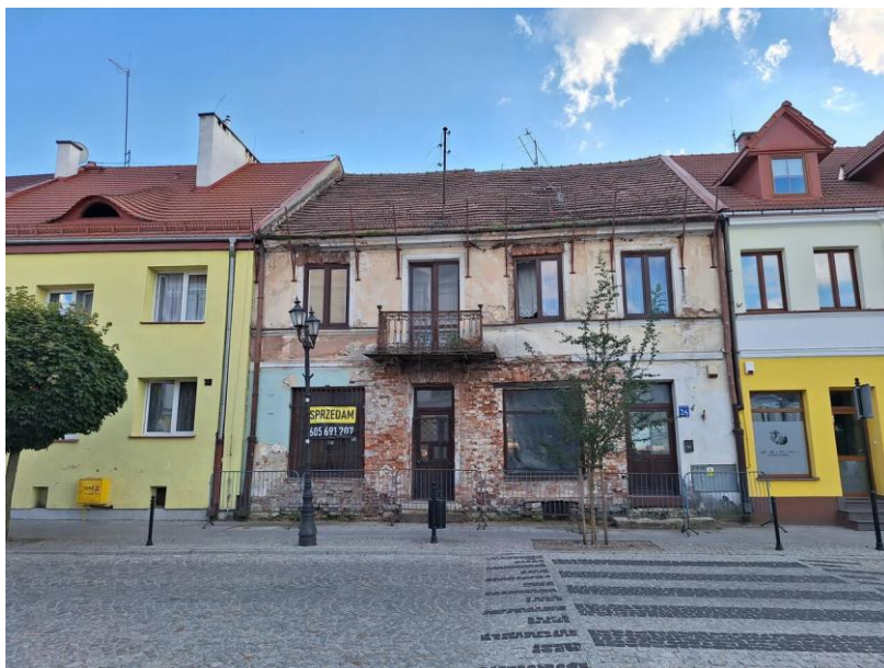
Fotografia 17. Jedna z zaniedbanych kamienic przy Rynku
