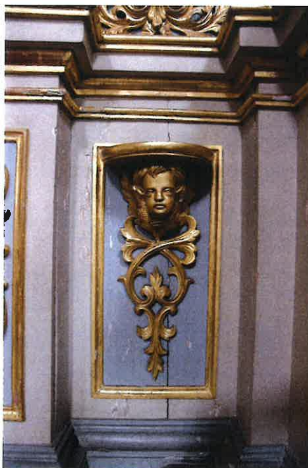
Fot.4 Ołtarz pod wezwaniem Najświętszej Marii Panny. Stan przed konserwacją ,widoczne ubytki warstwy malarskiej wraz z zaprawą do drewna i szpary w drewnie.
